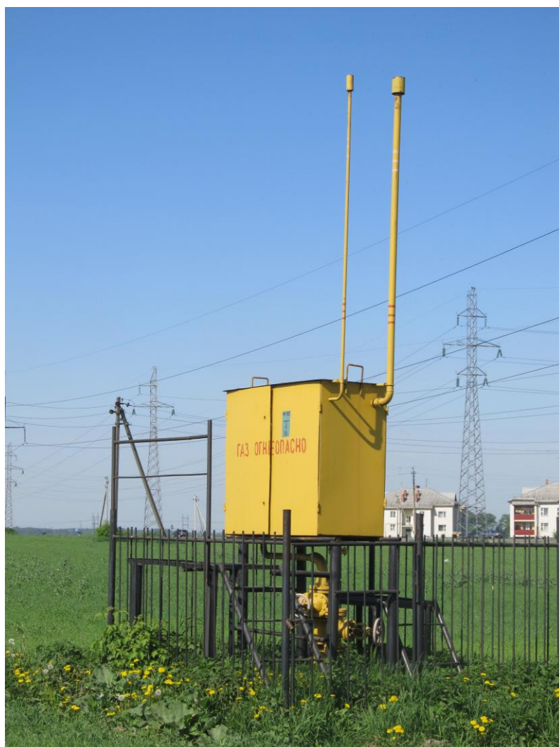
Рисунок 13. Шкафной газорегуляторный пункт.
